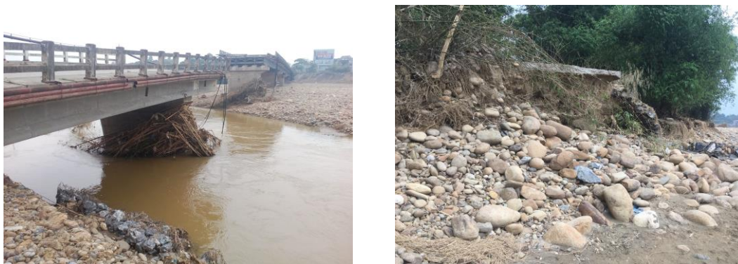
Hình 11. Hình ảnh cây trôi tích tụ tại trụ cầu và sạt lở bờ sông ở khu vực cầu Ngòi Thia.
