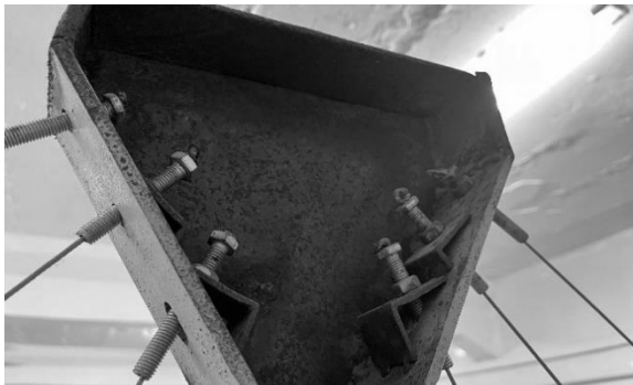
Hình 6. Hệ thống điều chỉnh lực căng dây văng tại đỉnh tháp.
