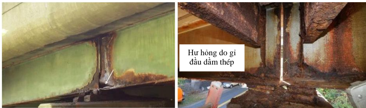
Hình 1. Hư hỏng cục bộ tại đầu dầm trên các gối trong dầm cầu thép (NCHRP Report 333 [2]).
