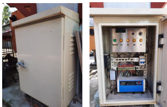
Hình 6. Tủ điều khiển trung tâm đường ngang (TT).
