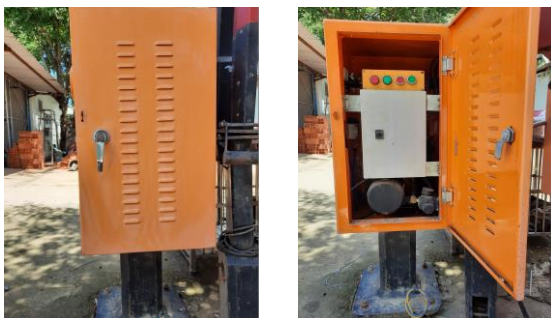
Hình 9. Tủ điều khiển cần chắn (tủ C) nằm bên trong thân trụ cần chắn sau khi chế tạo.
